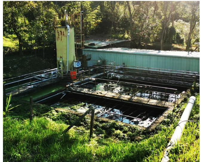
東勢林場園區內的廢水處理設備
